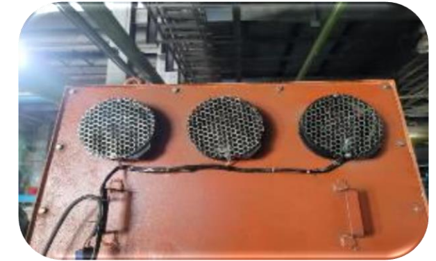
Provision of fan
